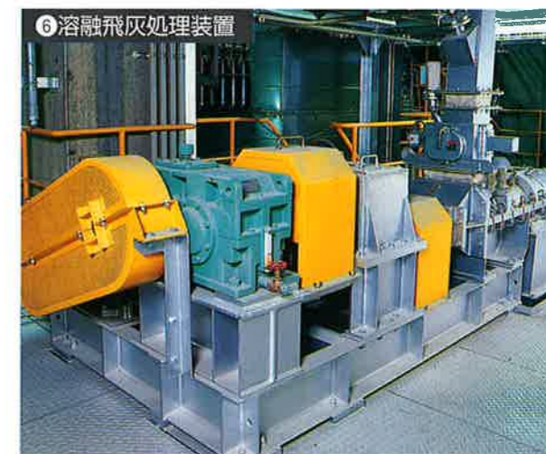
バグフィルタから払い落とされた集じん灰及びガスクーラで捕集されたばいじんを、安定無害化する装置です。
