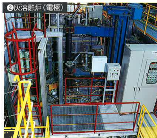
溶融炉では2本の黒鉛電極と溶融物間で高温のプラズマアークを発生させ、そのエネルギーにより灰を溶融します。電極の継ぎ足しは電極継足装置（ロボット）により行うため、簡単に継続運転ができます。
