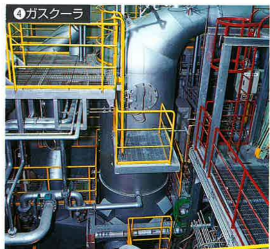
灰溶融炉からの排ガスを冷却する装置で、噴射水は完全蒸発するドラムボトム方式を採用しています。なお、ガスクーラで捕集されたばいじんは溶融飛灰処理装置へ送られます。
