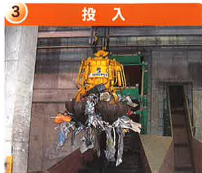
3 投入 クレーンで投入 ごみピットのごみは、クレーンで持ち上げられた後、コンベアで破砕機へと運ばれます。
