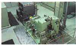
▲蒸気タービン発電機
