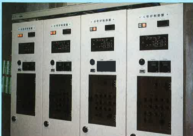
新火葬炉制御盤
