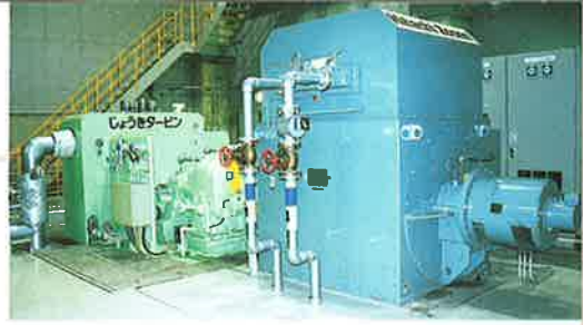
蒸気タービン発電機
