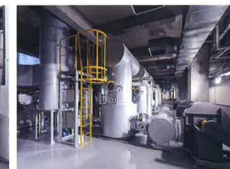
排ガス処理室
