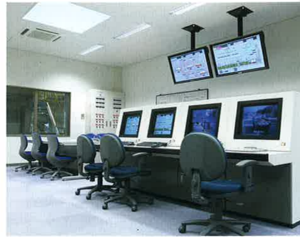
中央監視設備
