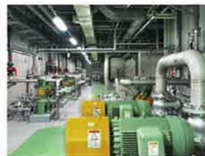
地下ポンプ室
