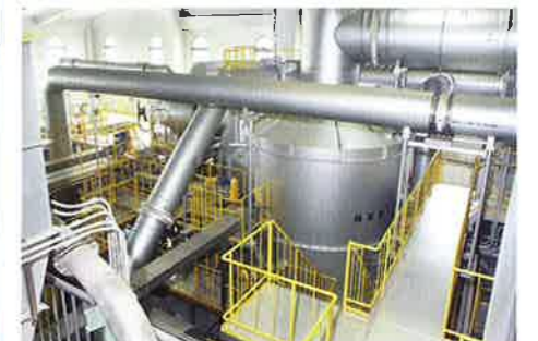
焼却・集塵設備
