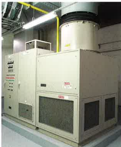
オゾン発生装置
